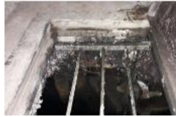
Dégradation des bétons sur les prétraitements
