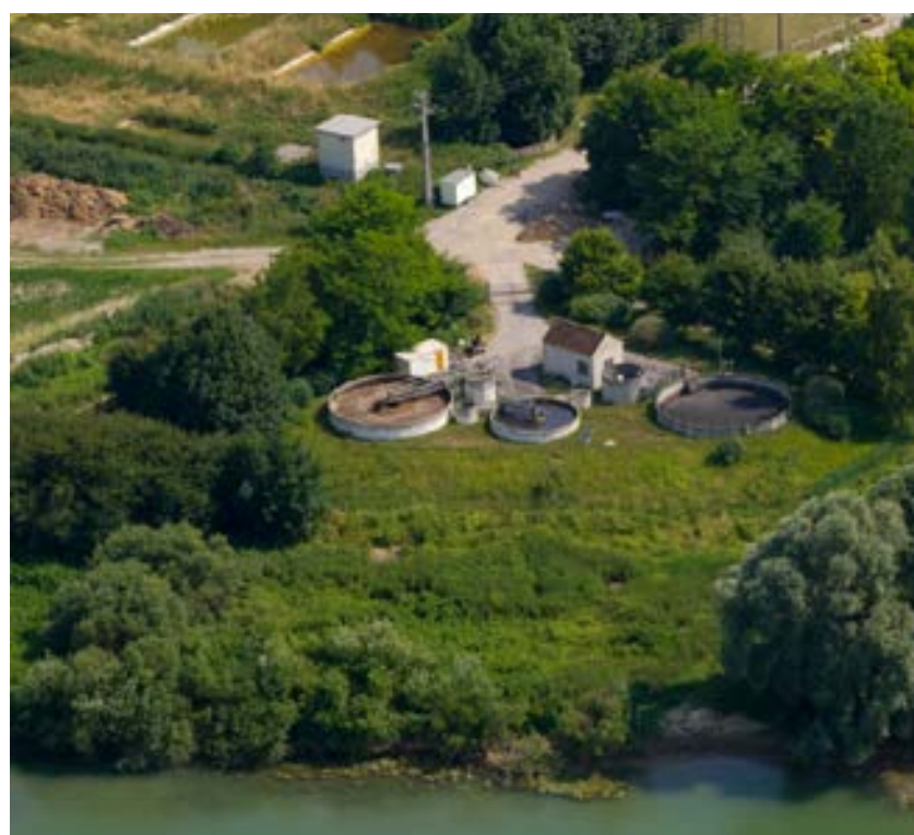
Station d'épuration de Jablines.
